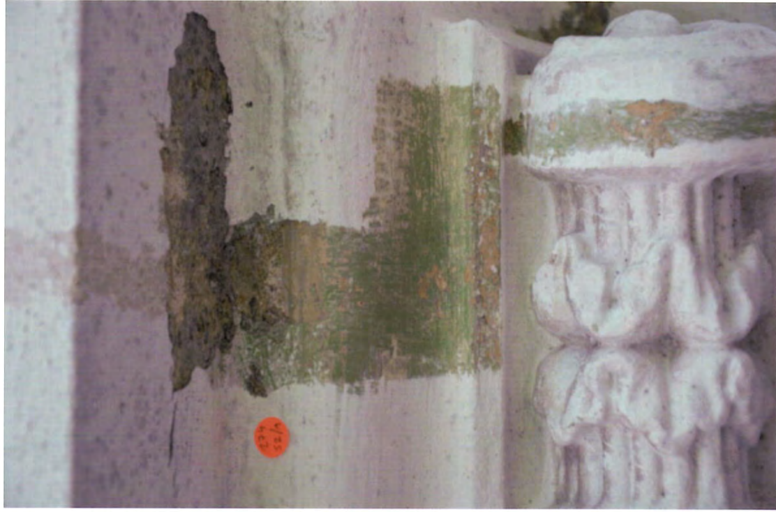
Obr. 9 Sonda 274/S2A. Detail povrchové úpravy odlitku.
