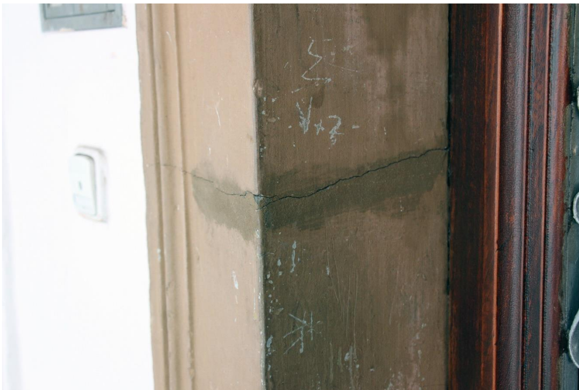
Obrázek 7 Detail poškození - prasklina na levé části portálu
