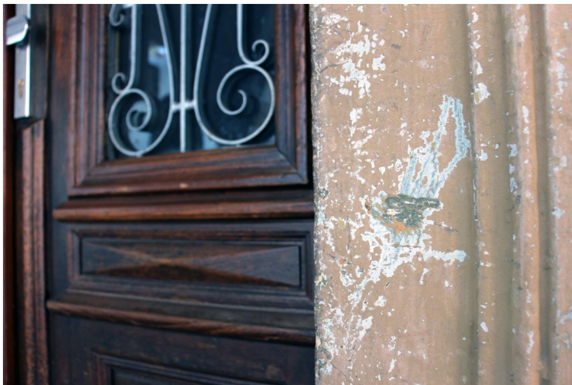
Obrázek 6 Detail poškození - degradované povrchové úpravy
